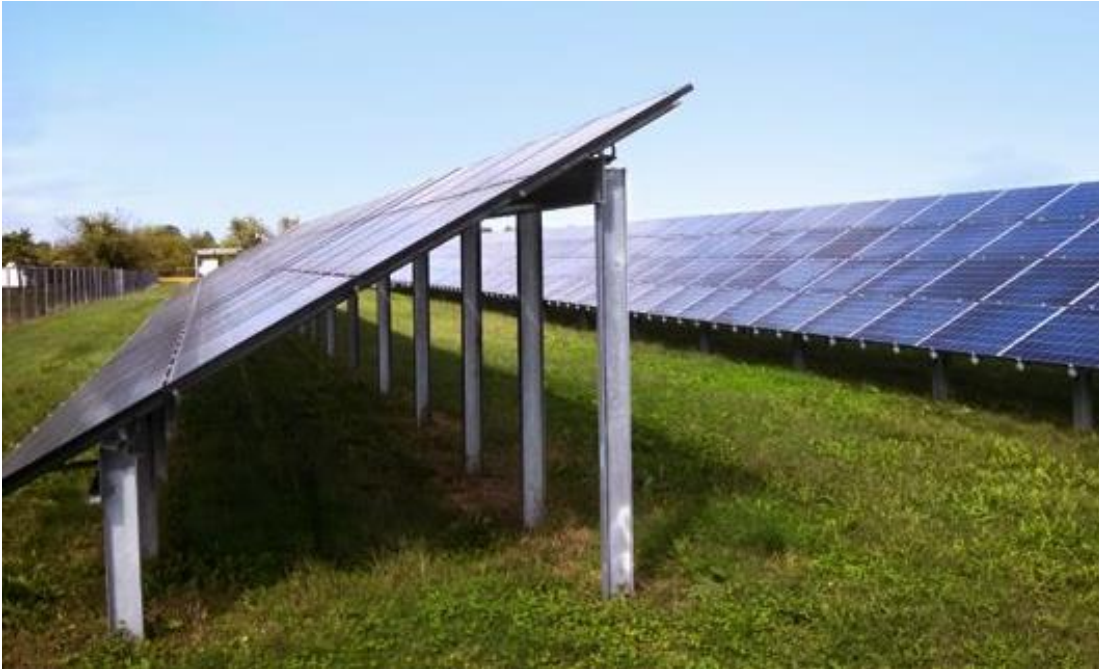
Figur 8: Fast-vinkel installasjonsløsning for illustrasjon (Foto: Willowbrook Solar).
