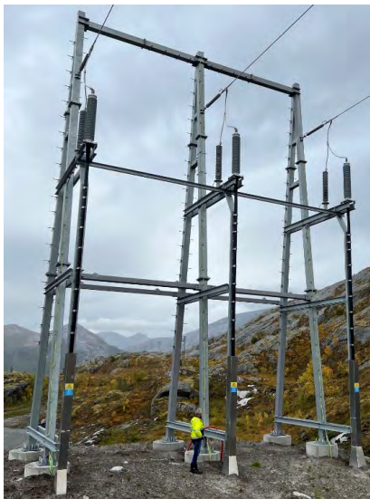
Kabelendemast med stativ
