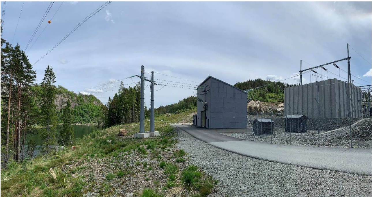
Figur 4-5. Bygget midt i bildet er Agder Energi sin koblingsstasjon ved Kvinesdal transformatorstasjon.
