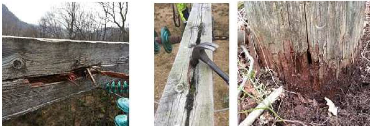
Figur 2-2. Råteskader og oppsprekking på traverser og master.
