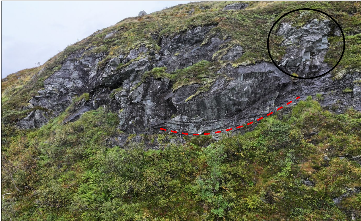
Figur 7: Bilete fjellpartiet øvst i påverknadsområdet. Berggrunnen har ei mørk framtoning, og er tolka å vere amfibolitt. Det er enkelte små brotplan (svart omriss) i fjellet, og nokre grunne sprekkdanningar. Sprekkeplana føl hovudsakleg foliasjonsplana og faldestrukturane (raud stipla linje), men det er òg sprekkplan normalt på foliasjonsplana, langs med fjelloverflata. Infopunkt 5.
