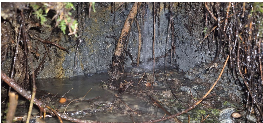
Figur 14: Påvist antatt leirholdig materiale i bekk ved kritisk skråning 3. Foto: SGC.
