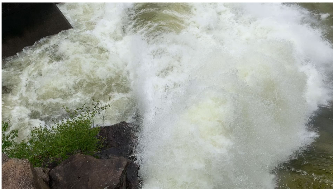
Figur 36. Overløp rett nedstrøms flomluke 2 (her sett nedstrøms fra damkrone) har en uheldig utforming idet sterk strøm møter en fjellnabbe.
