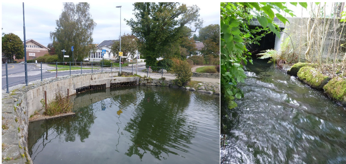
Figur 3-2 Innløpet (t.v.) og utløpet (t.h.) til kulverten som går gjennom Hommersåk sentrum fra Stemmen til nedenfor Sentrumsgården.
