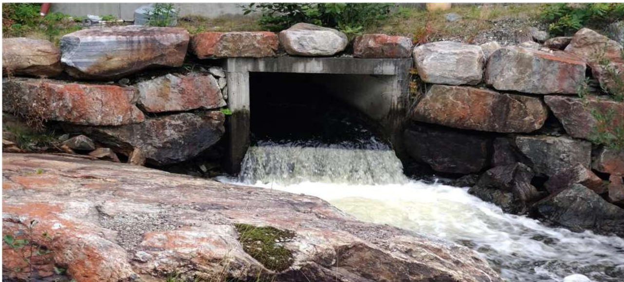
Figur 39: Eksempel på utforming av utløpskanalen i eit småkraftverk på 1,6 MW i Telemark.
