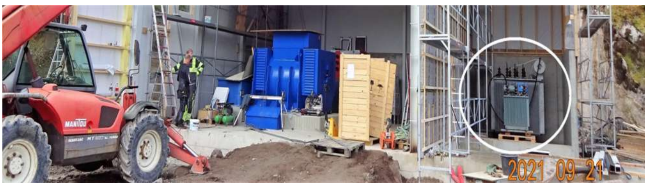
Figur 48: Trafo er planlagt plasserast i eit separat høgspenntrom i kraftverket, slik som illustrasjonsfotoet viser.
