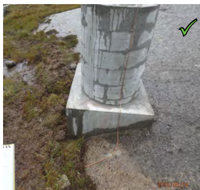
Figur 23: Korrekt utført jording. Ledningen er festet langs fjellet, før den går ned i jord.
