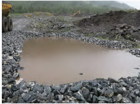
Figur 40: Prosjektert sedimentasjonsbasseng. Utløpet er neddykket for at eventuelle oljerester skal kunne samles opp på overflaten i bassenget.
