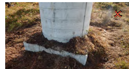
Figur 19: Ikke god overgang mellom stabbe og terreng. Massene oppå betongen vil tørke ut.
