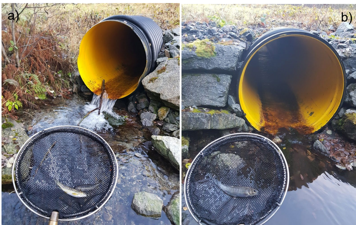
Bilde st4. Kulvert gjennom fylkesveien er vandringshinder for oppvandrende laksefisk. Hellingen i kulverten er lav, men høydeforskjellen kan gjøre det vanskelig å passere. a) Kulvert sett fra nedsiden av fylkesveien. b) Kulvert sett fra oversiden av veien. På oversiden av veien står vannet i dype grøfter med stillestående vann. Området er svært begrodd. Substratet består av silt og fin grus med innslag av større stein. Foto: Knut Andreas E. Bækkelie, NINA.
