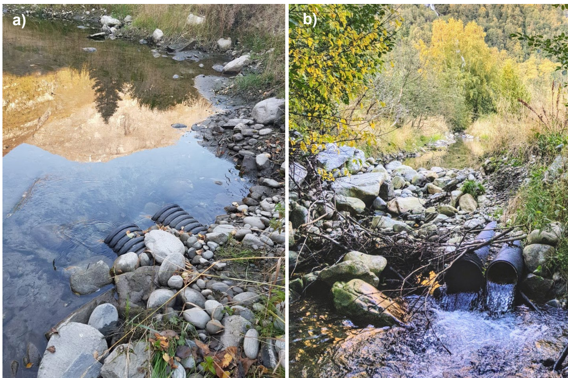
Bilde n6. Oppdemmingen skyldes at bekken er lagt i to små rør i antatt traktorvei. a) Oppstrøms og b) nedstrøms traktorveien. Veien er ikke vedlikeholdt, og ved store vannmengder vil vannet renne over hinderet. Foto: Knut Andreas E. Bækkelie, NINA
