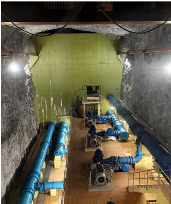
Figur 8 Bergrommet med pumpestasjon PV1
