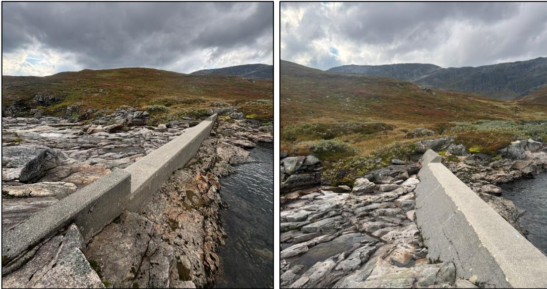
Figur 3-22 Murane bekkeinntak, vestre overløpsterskel. Terskelen skal utvides med ny ledevegg i terrenget vest fra dagens anlegg, for å sikre for flomavledningen for dammen. Foto: Sweco Norge.
