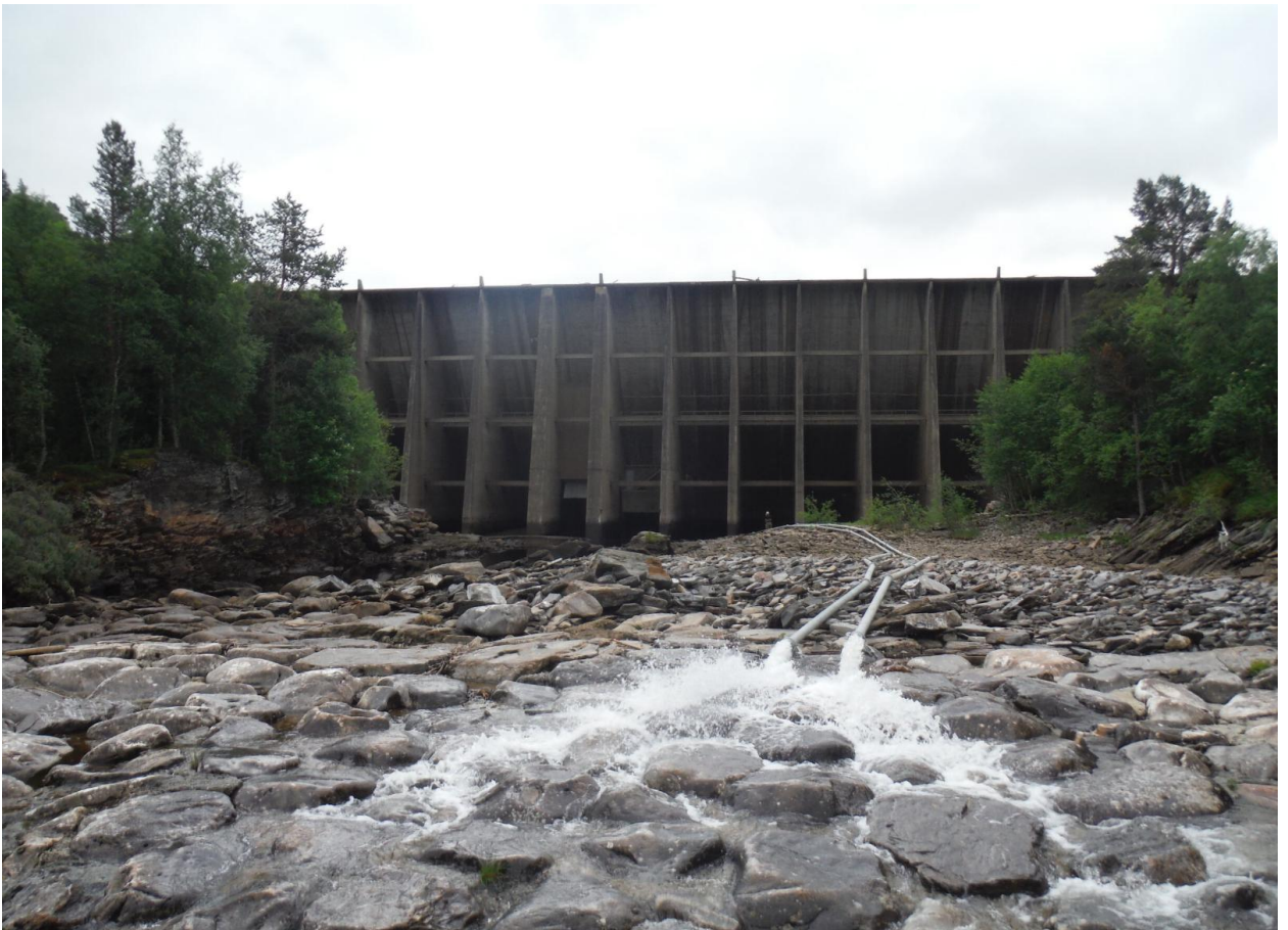
Figur 5 Tidligere senkning av vannspeilet.
