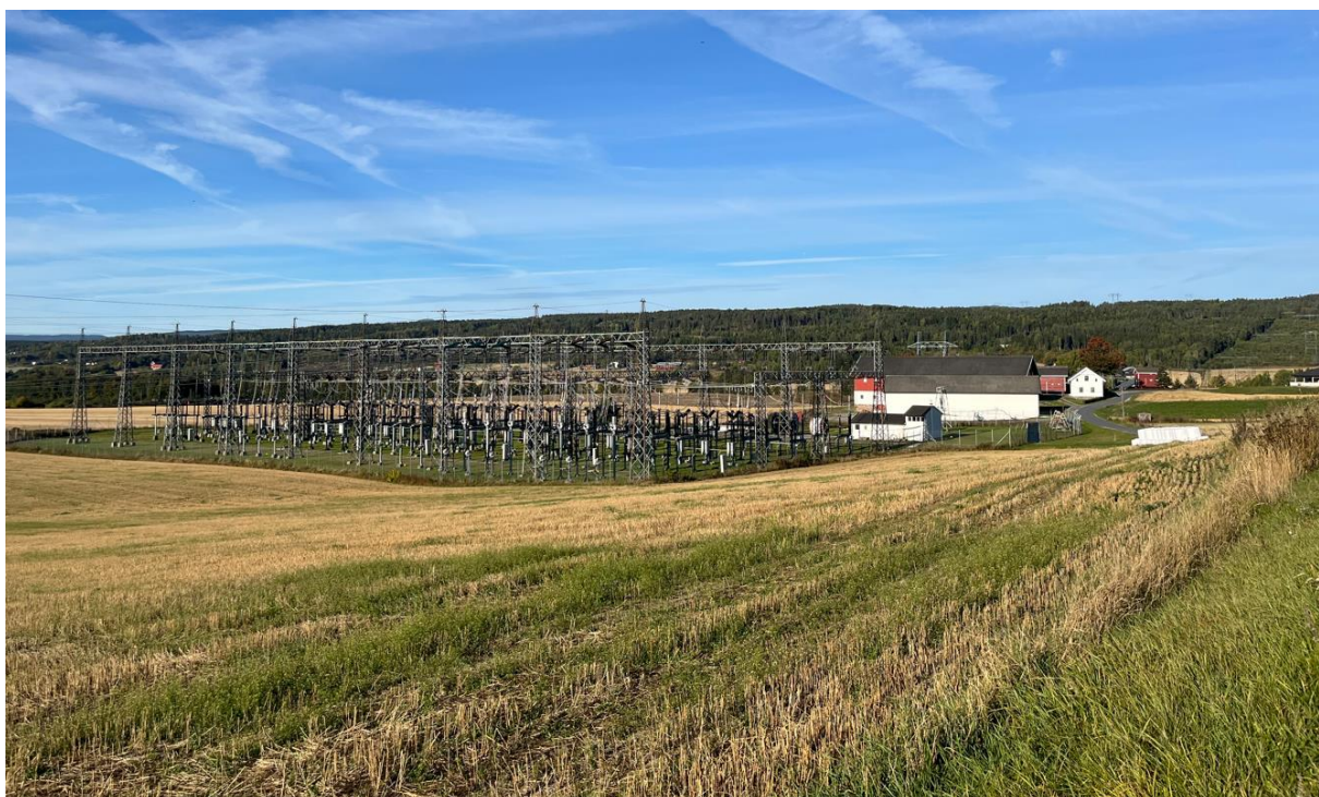
Figur 4-76 300 kV-koblingsanlegg som skal saneres. Multiconsult anbefaler at tilbakeføring til landbruksareal utredes nærmere (Foto: Multiconsult).
