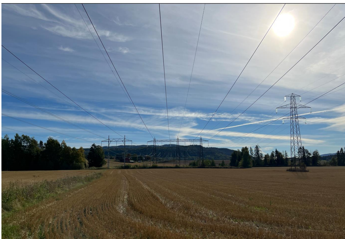
Figur 4-77 300 kV-anlegget og Nomeledningen til høyre, som skal erstattes med nye ledninger og saneres (Foto: Multiconsult).
