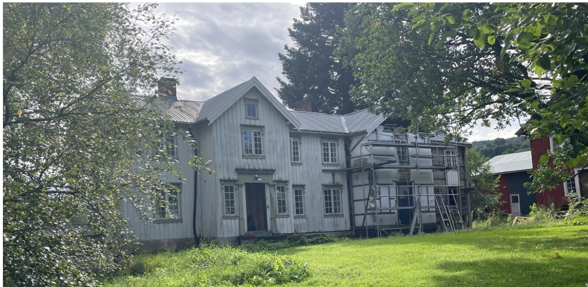
Figur 36 Våningshuset på Bakk har stor grad av autentisitet, men er preget av manglende vedlikehold. Foto: Guro Skjelstad, Asplan Viak AS
