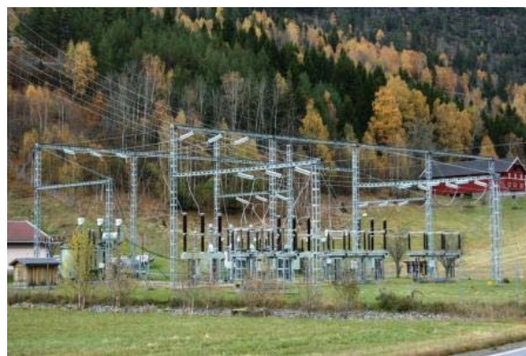
Figur 7-18 Bildet viser et typisk koblingsanlegg av typen som er tenkt etablert ved Øyan. (Foto: Sofienlund)
