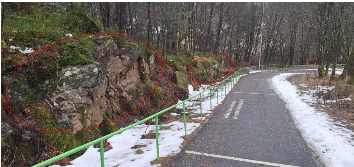
Figur 7: Berg i dagen ved gangveg mellom grusbane og Sandgotna borettslag. Lokalteten ligger innenfor aktsomhetsområde for kvikkleireskred.
