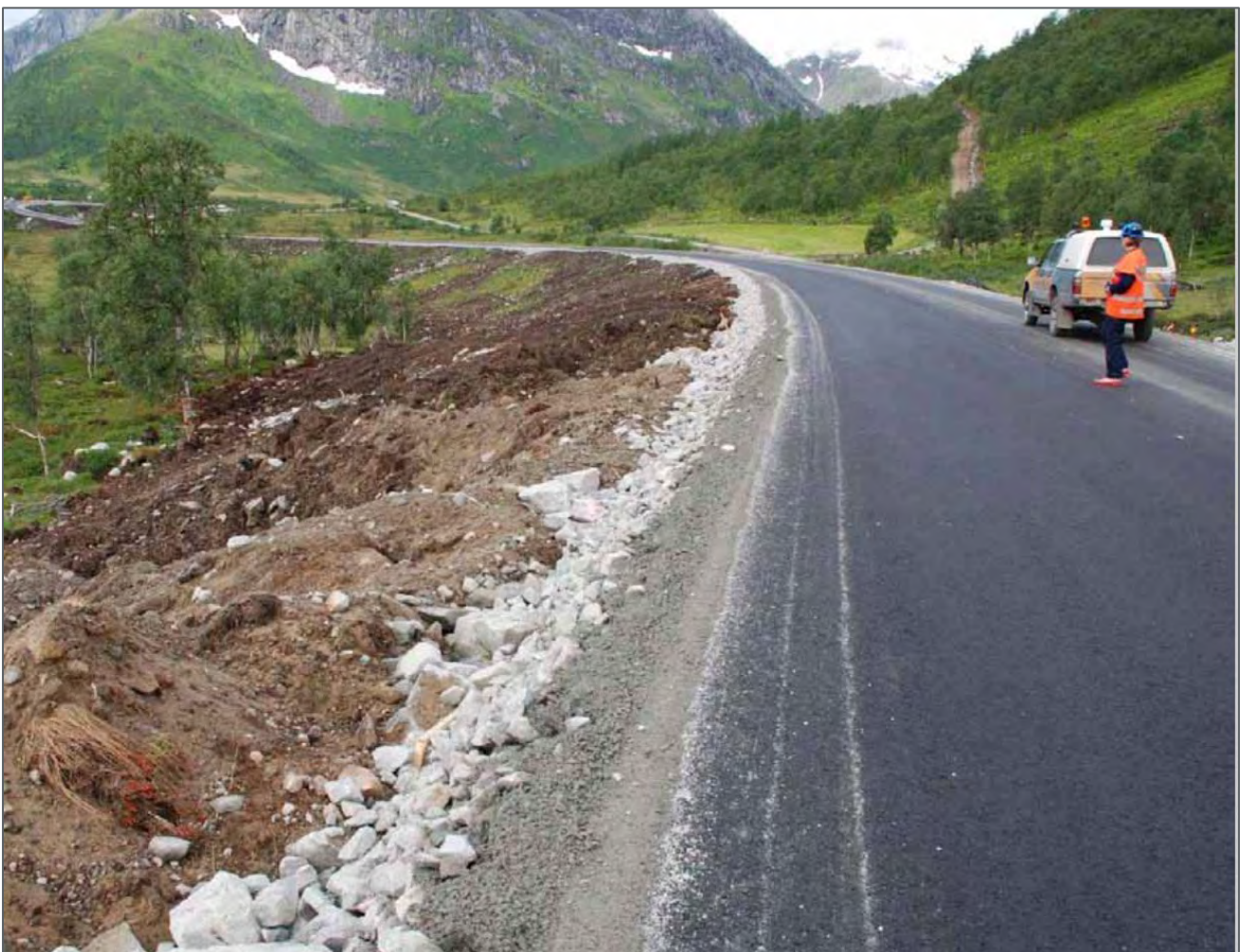
Figur 3-16: Ved utlegging av toppmasser skal ikke massene komprimeres (klappes). Massene nærmest i bildet er ikke ferdig utlagt. Kilde: (Hagen & Skrindo, 2010). Foto: A. B. Skrindo.
