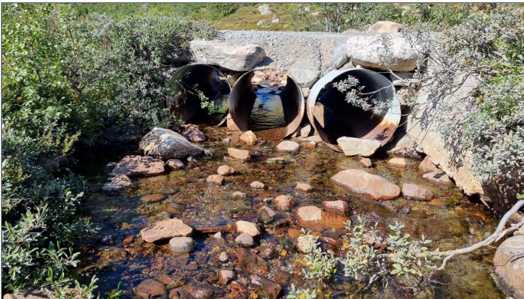
Figur 2-20: Rørkulverter i Sauhovdbekken (Flottebekken). Foto: Norconsult AS.
