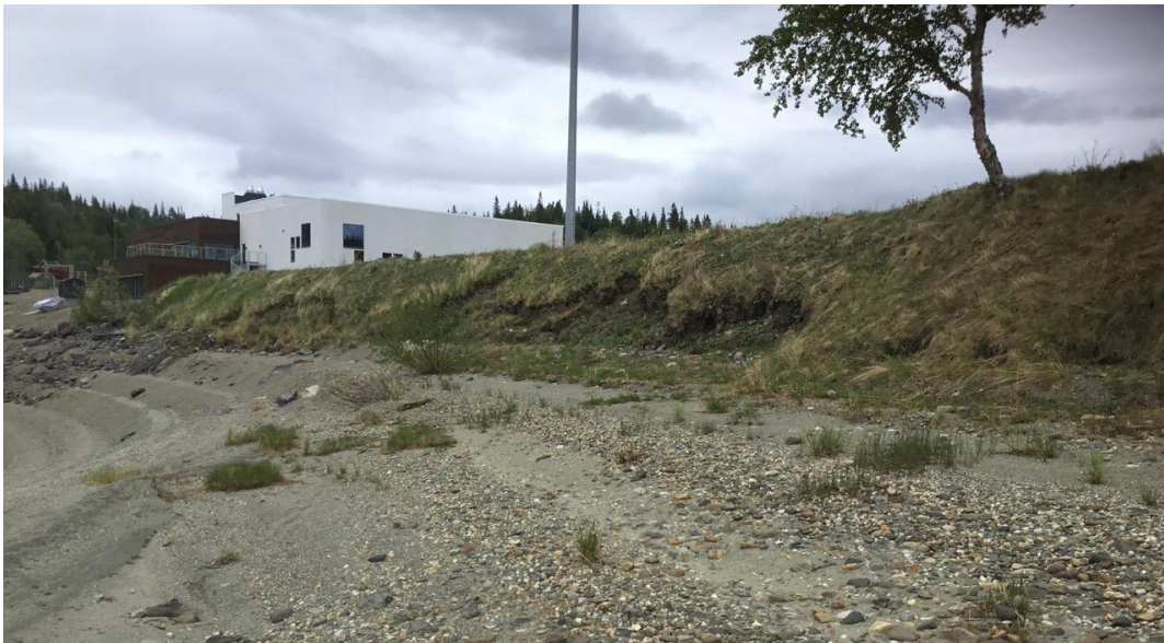
Figur 2-20 Jordvoll som har erodert mot kunstgressbanen.
