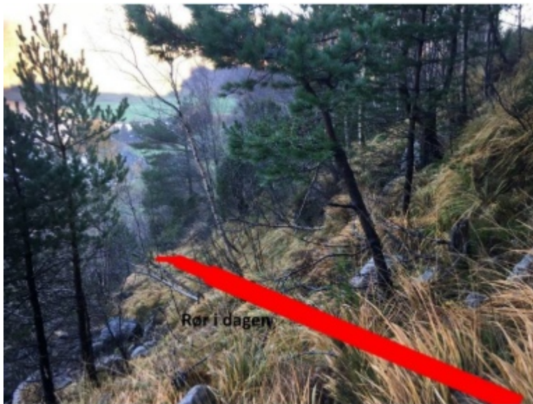
Fig. 8: Øvre del av vannvei – rør i dagen
