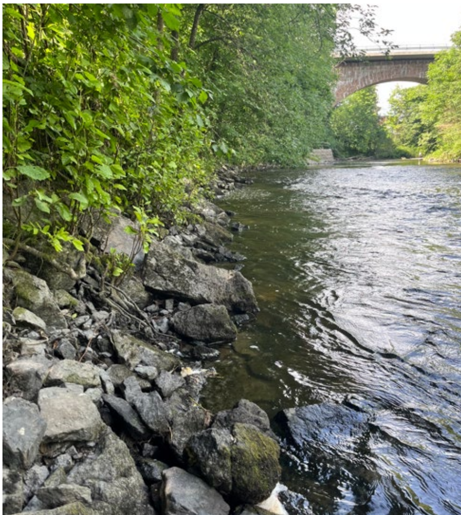
Figur 3.8 Bilde av erosjonssikringsanlegg langs vestbredden av Lierelva. Bildet er tatt oppstrøms, mot brua på Ringeriksveien.
