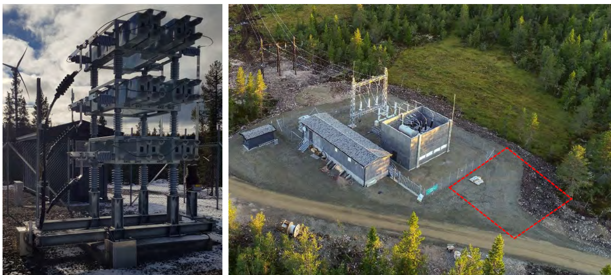
Figur 1: T.v.: Bilde av eksisterende kondensatorbatteri. T.h.: Flyfoto over eksisterende koblingsstasjon. Omsøkte tiltak vil endre uttrykket innenfor den røde stiplede firkanten (Kilde: Austri Vind DA).
