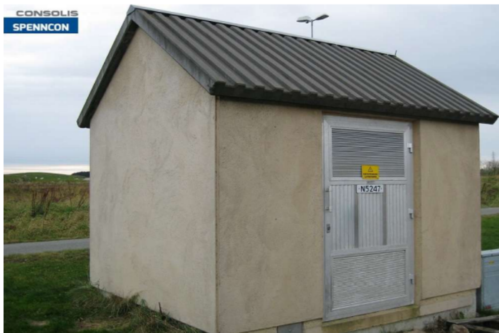
Figur 2: Bilde av tilsvarende frittstående nettstasjon. Kilde: Konsesjonssøknad til Mibau Stema Norge av 15. mars 2025
