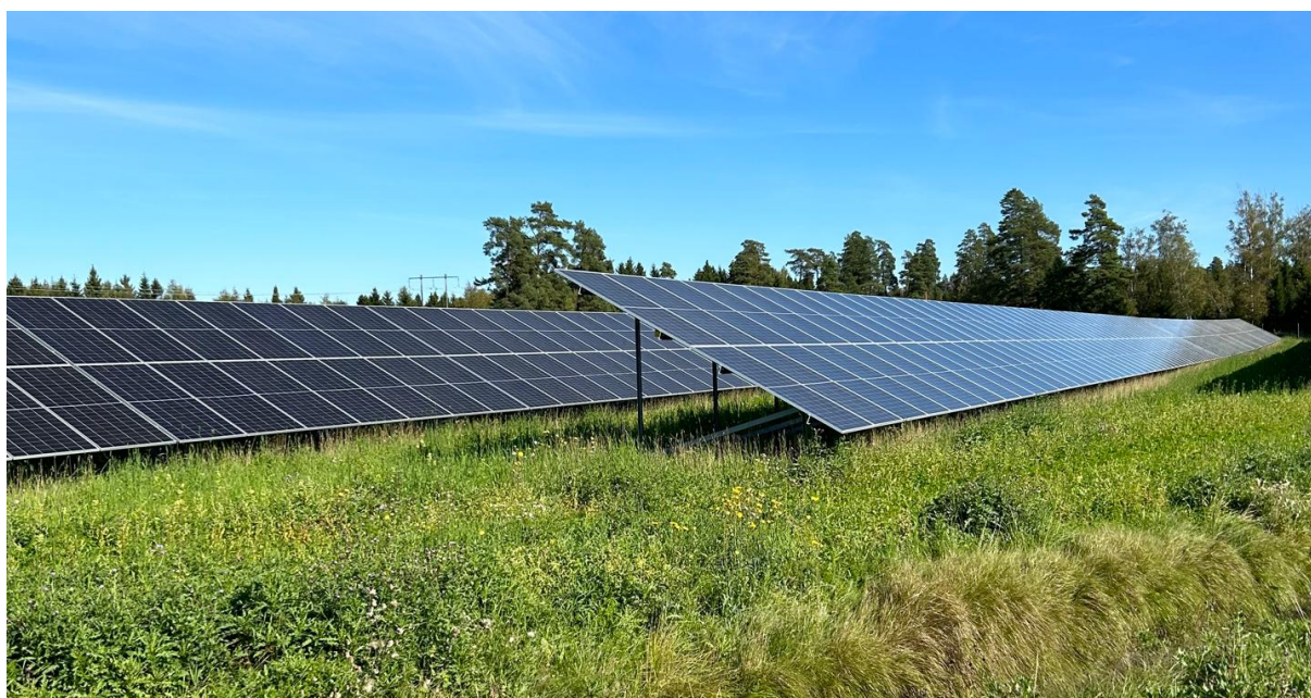
Figur 7 - Solcellepaneler montert i portrett
