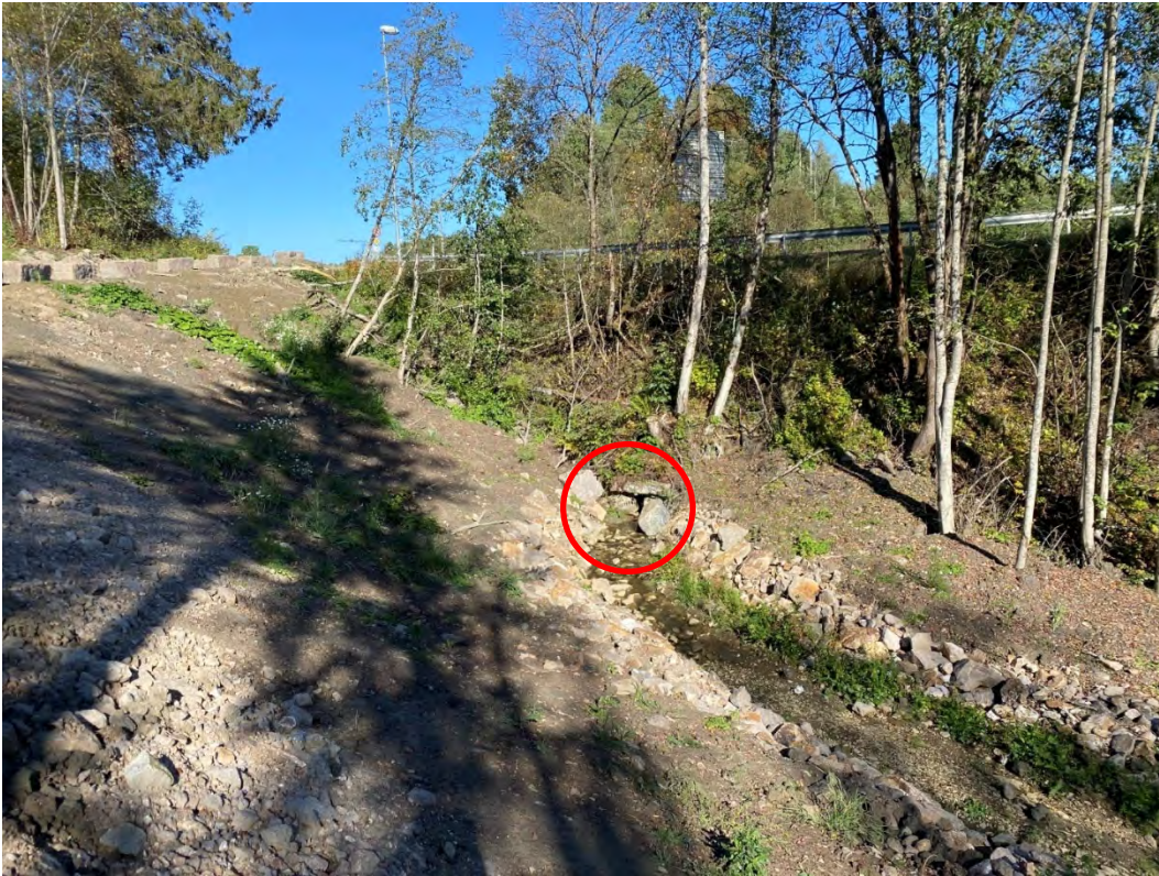
Figur 76: Bildet viser øvre ende av sikringa i Engelstadbekken ved kulvert (rød sirkel) under Nannestadvegen. Kulverten under Nannestadvegen har for liten flomavledningskapasitet.
