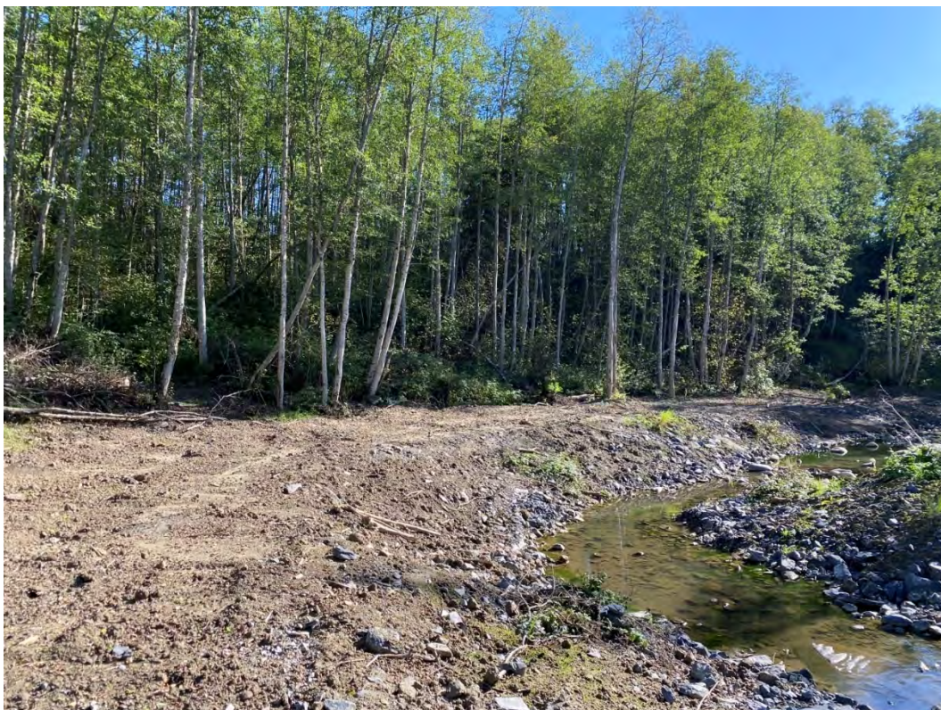
Figur 47: Venstre yttersving ved ca. P690. Avlastningsmasser som støttefylling mot venstre kant
