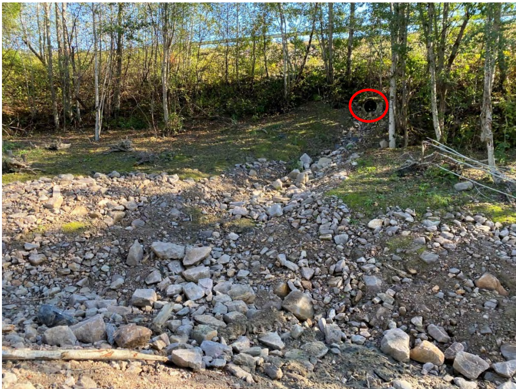
Figur 67: Sideravine venstre side ved P220. sikret helt opp til utløp rør (rød sirkel) under Fv. 120.
