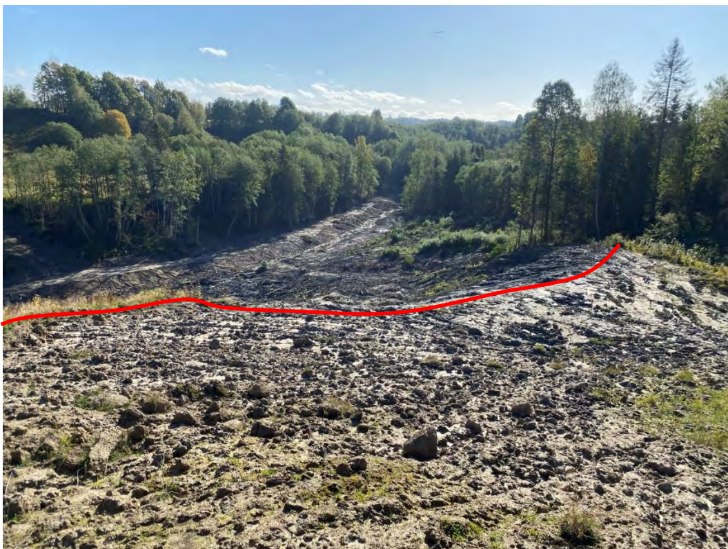
Figur 84: Skråningskant skred mars 2020 avlastet og stabilisert (rød strek)
