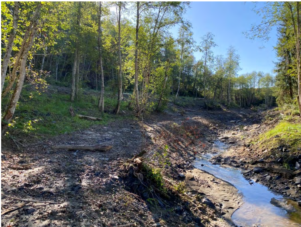
Figur 49: Stor støttefylling venstre side på strekning P1000-P1050. Bildet tatt fra P1000 og nedover bekken
