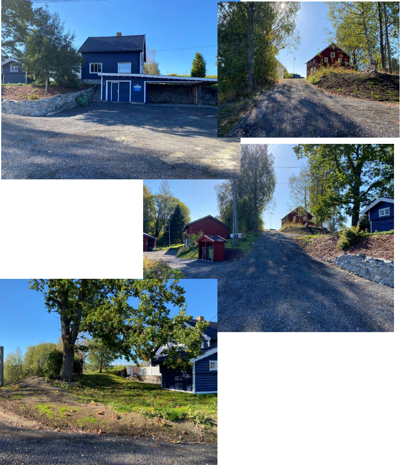
Figur 96: Innkjørsel til eiendommene Nannestadvegen 130, 134 og Senepsrud gård. Satt i stand etter avtale med grunneiere.
