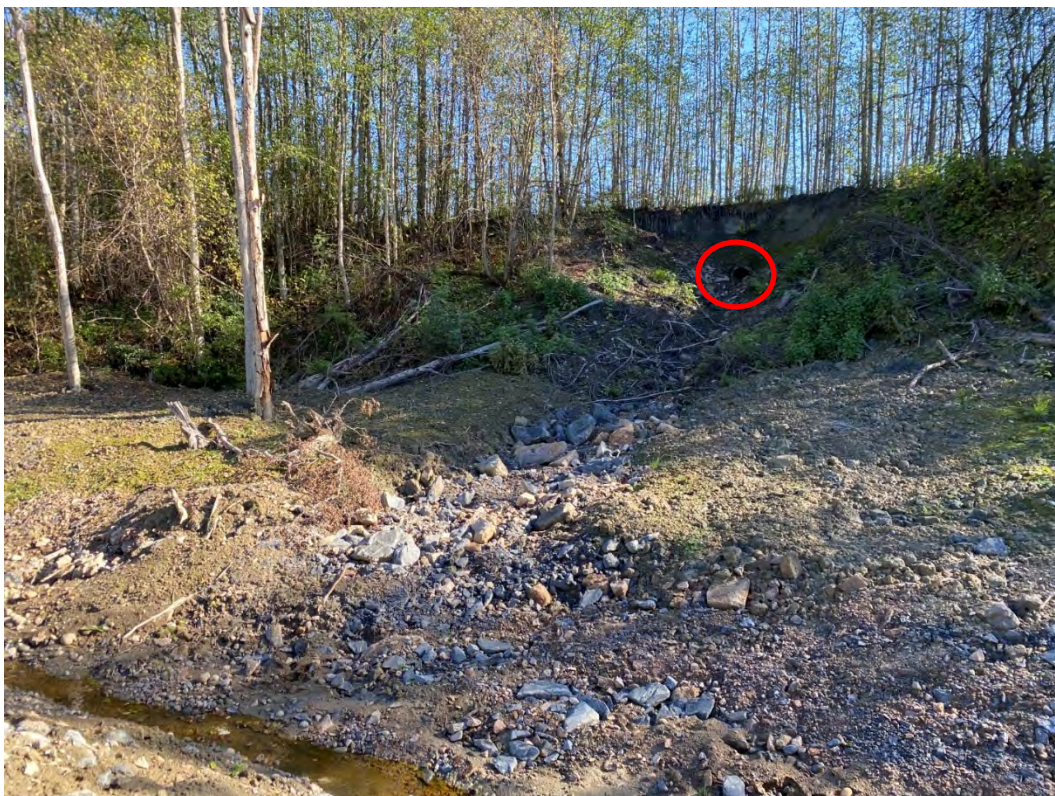
Figur 69: Sideravine venstre side ved P110. Sikret helt opp til utløp rør (rød sirkel) under Fv. 120.
