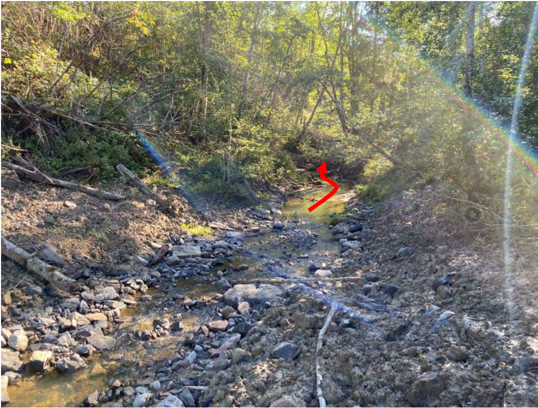
Figur 58: Nedstrøms ende på sikring i Leirbekken ca. ved P1380. Rød pil viser usikret strekning
