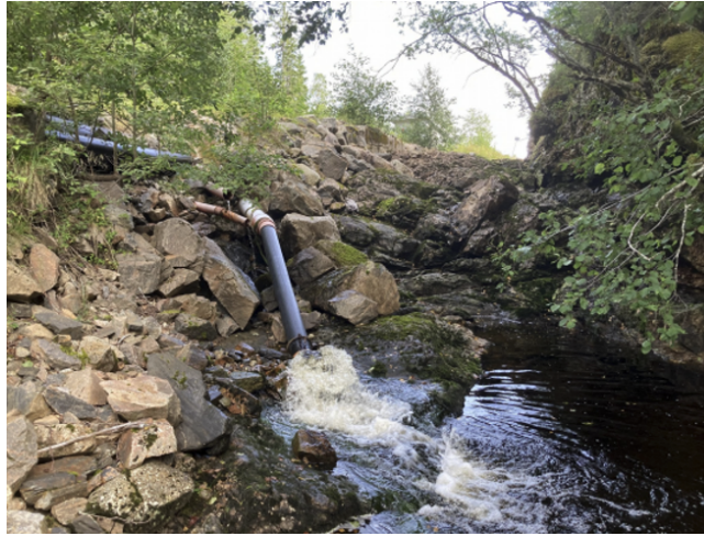
Figur 11: Viser utslipp av minstevannføring nedstrøms demning Ausvatnet ved lav vannstand.
