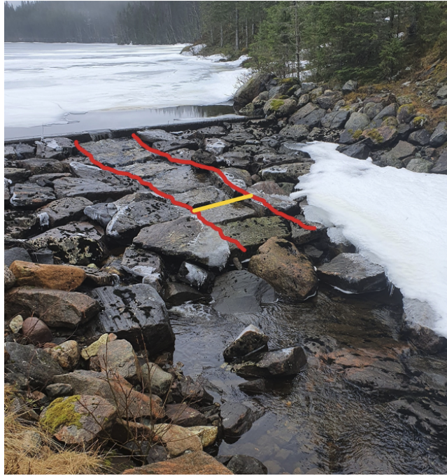
Figur 33: Steinblokker nedstrøms demning, markert rødt. Vannet renner over de sprengte steinene til og stein nummer 5 (markert med gul strek).
