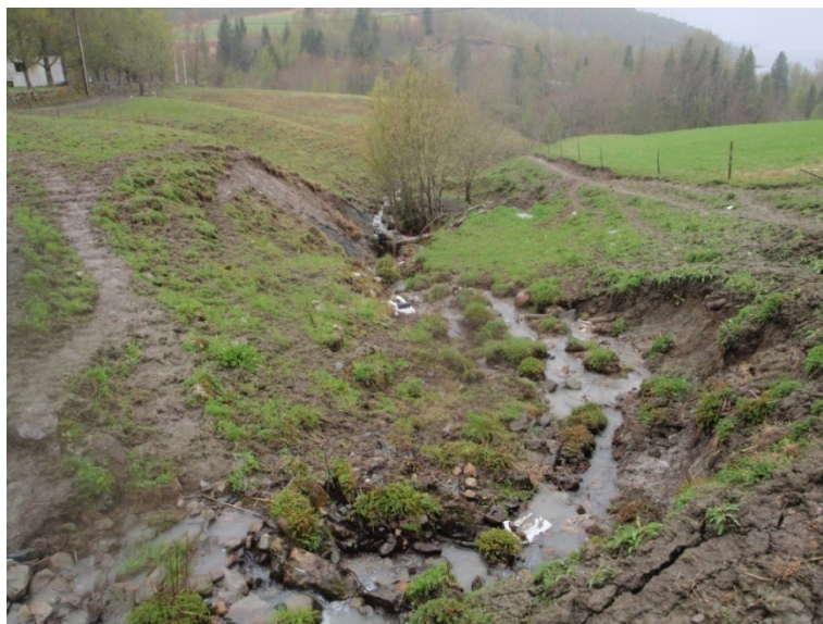
Bilde 2.1 Aktiv erosjon i bekk midt i sona ved kirka
