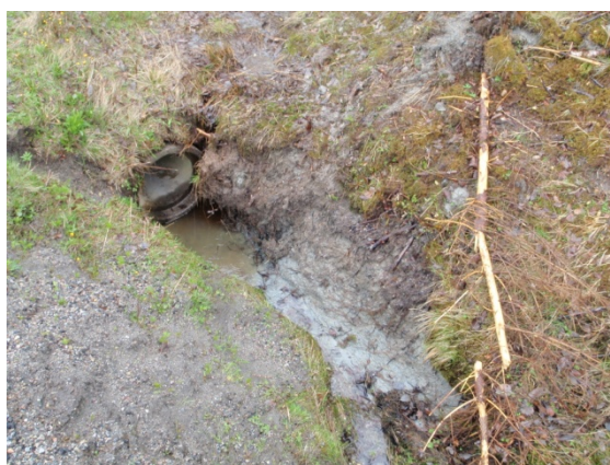
Bilde 2.7 Erosjon under rør i grøft i Ramsvika-sona
