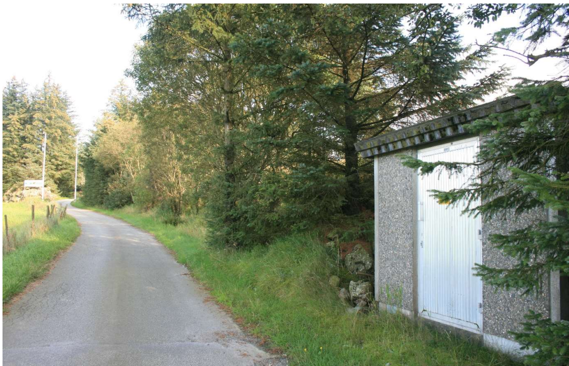
Figur 11. Koplingsstasjon nr 1216 til Jæren E-verk sitt 22 kV nett (ved innkjøring til motorsportsenteret).
