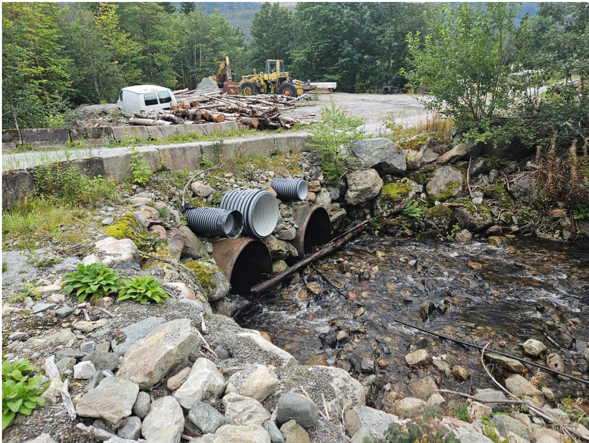
Figur 15: Vei på tvers av utløpet til Grobrudalen. Bildet er tatt ved GPS punkt 950 fra befaringen.
