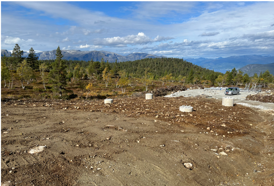
Bilde 14: Rundt mastepunktet er toppmassene rufset fint til, mens nærmere fotografen er massene klappet. Bildet er fra området ved B9B/B9C på Frønningen. NVE påpeker at massene skal rufses for å fremme raskere tilvekst. Foto: NVE.
