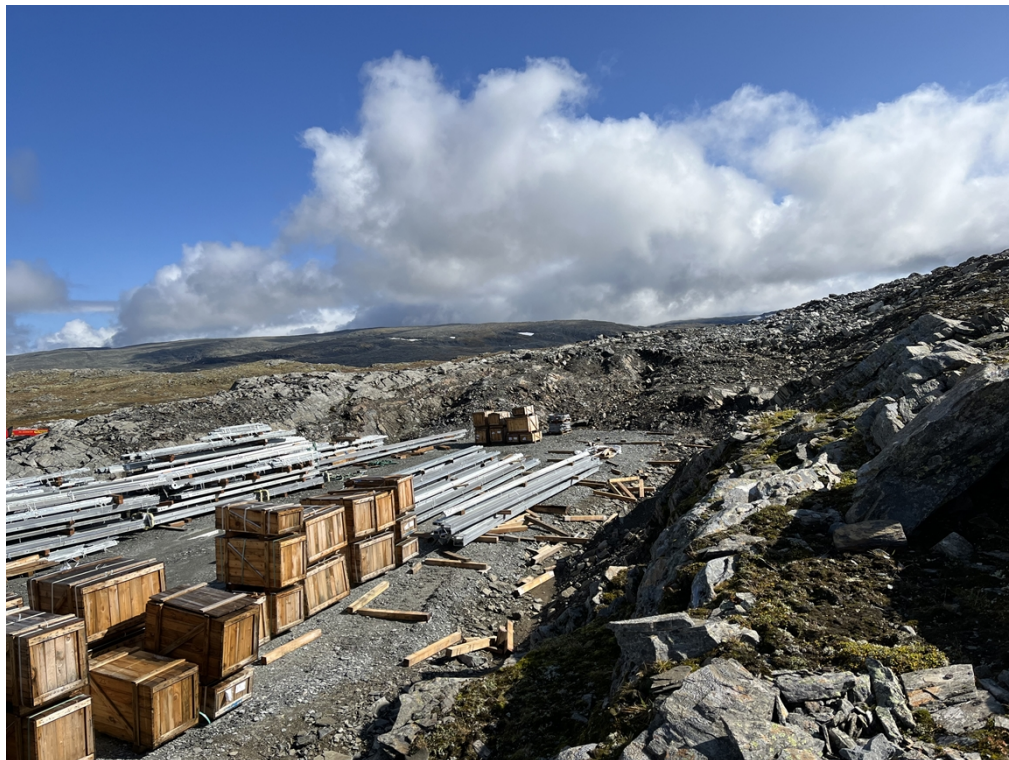
Bilde 9: Massetak i enden av veg R3 på Aurlandsfjell. Dette skal lukkes og istandsettes. Foto: NVE.
