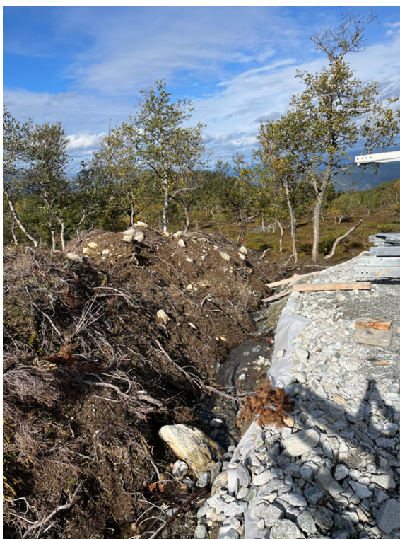
Bilde 2: Eksempel på bruk av duk mellom terreng og bærelag. Dette er fra B9B/B9C på Frønningen. Foto: NVE.
