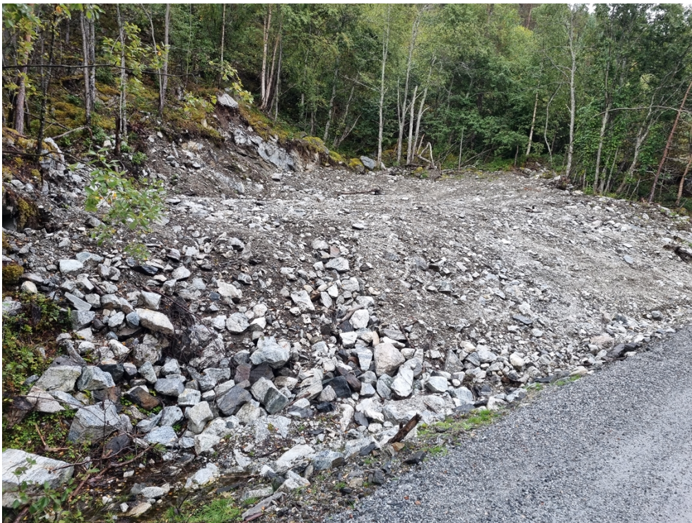
Bilde 11: Massetak/sidetak MF3 på Fimreite som NVE mener ikke er godt nok terrengformet og istandsatt. Foto: NVE.
