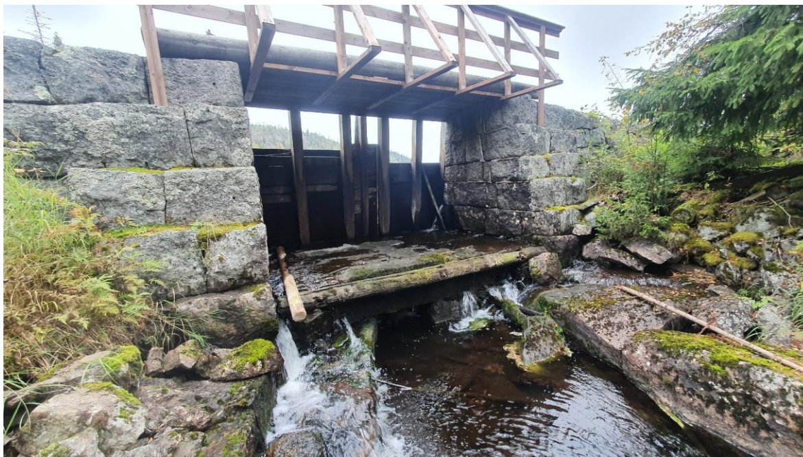
Figur 1-4 Lekkasje sett fra dammens nedstrøms side, ved tappeluken. Foto: Multiconsult Norge AS.
