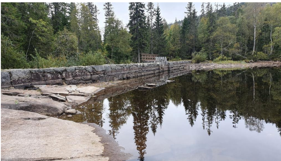
Figur 4-3 Lekkasje i dammen medfører at vannstanden senkes. Foto: Multiconsult Norge AS.
