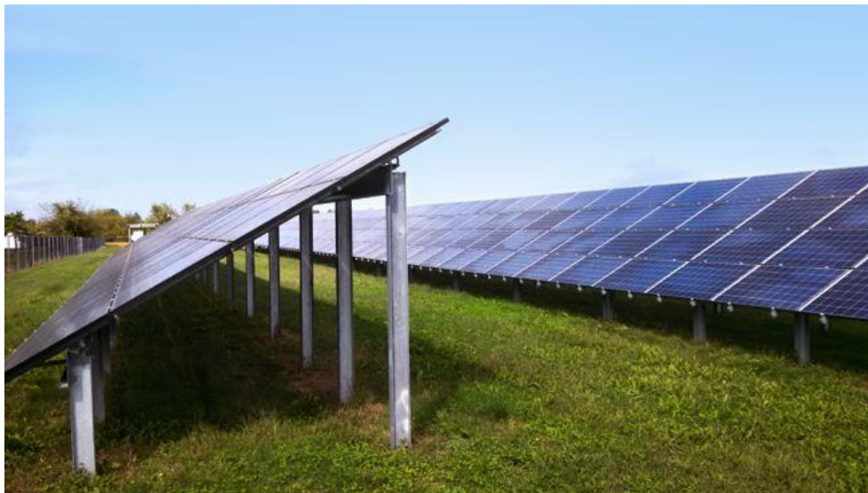
Figur 3-3: Eksempel på fast-vinkel installasjonsløsning (foto: Willowbrook Solar)
