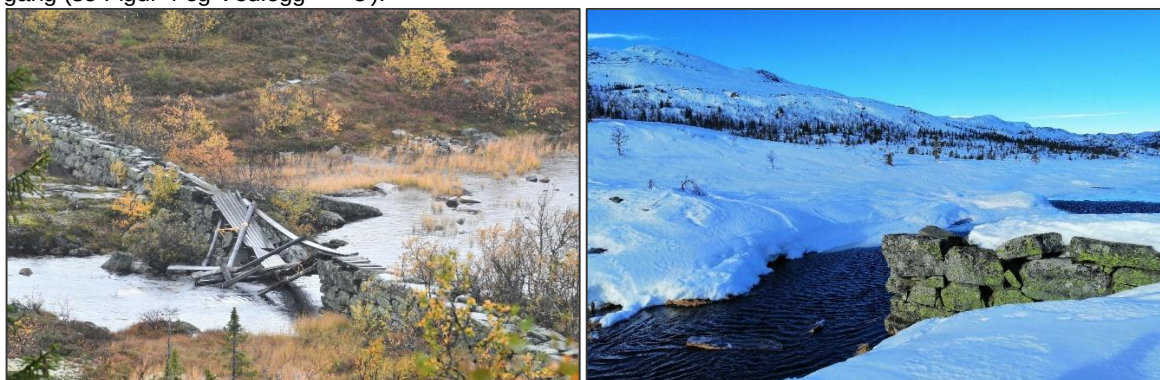
Figur 44. Bilde til venstre: Kollapset demning ved Fyrisjøen høsten 2020. Kilde: bilde tatt 24.09.2020 (Knut Sterud). Bilde til høyre: Demning ved Fyrisjøen vinterstid. Bilde tatt mot nordvest. Mur på sørvestlig bredde er dekket av snø. Kilde: bilde tatt under befarig 26.02.2021 (Rambøll).
