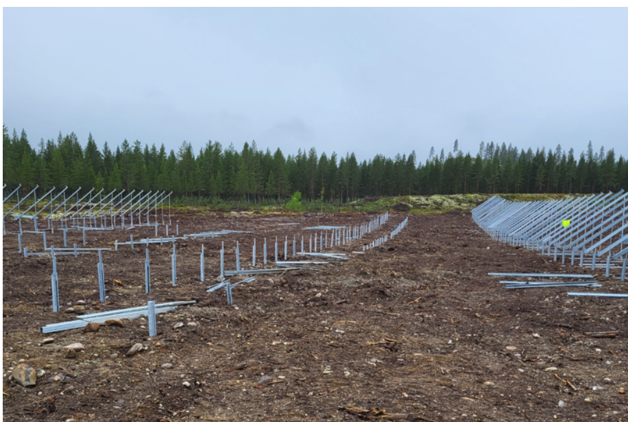
Bilde 3. Solcellestativer under montering i det nordre delområdet. Det forbores før peling, men stein raser tilbake i borehullet og gjør pelingen svært vanskelig. Stativene blir bøyde og skadet.
