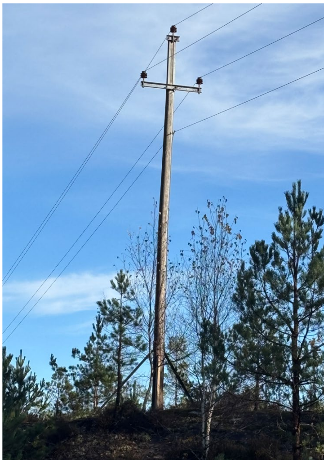
BILDE 3 ENKEL MAST MED LEDNINGER TATT VED NOMELAND KRAFTSTASJON
