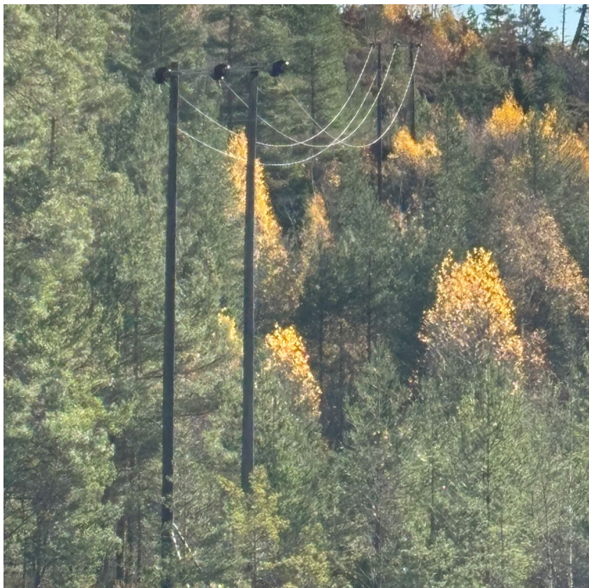
BILDE 4 TYPISK H-MAST FOR 11 kV LINJEN
