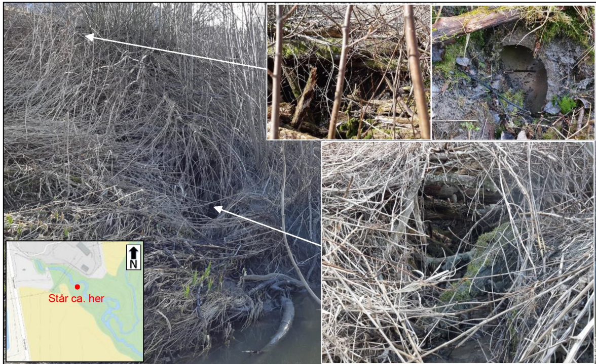
Figur 4.12: Står nede i bekken og tar bilde mot transformatorstasjonen i nord, som viser at det er oppstått en dyp kanalisering i skråningen, trolig som følge av tilført overvann over tid (Fra befaring 09.04.2021)
