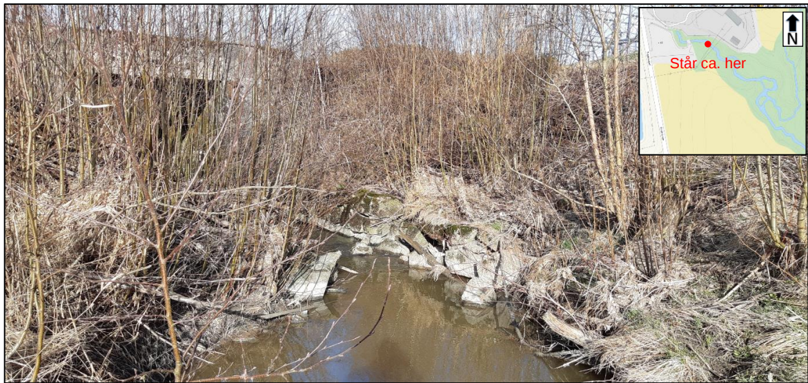
Figur 4.9: Står i bekken syd for stasjonen og tar bilde mot vest. Bildet viser at noen av steinene har falt ut i bekken (Fra befaring 09.04.2021)
