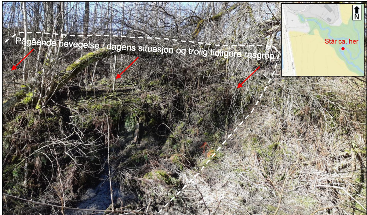
Figur 4.2: Står i ravinedalen og tar bilde mot jordet i sydvest, som viser at skråningen består av mye skjevstilt busker og trær som indikerer pågående bevegelse i skråningen. I bakkant av skråningen er det indikasjon på tidligere rotasjonsskred som samsvarer med prøveserie tatt i borpunkt 15 på toppen av skråningen (Fra befaring 09.04.2021)
