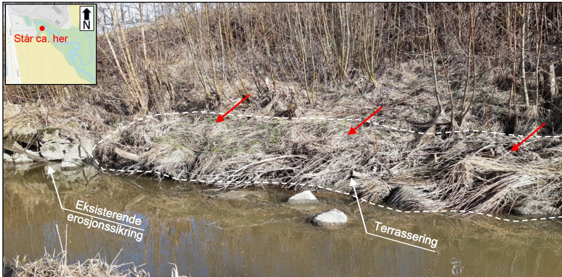
Figur 4.10: Står syd for bekken og tar bilde mot nord, som viser terrassering av løsmasser i bunn bekk og indikerer bevegelse i skråningen (Fra befaring 09.04.2021)
