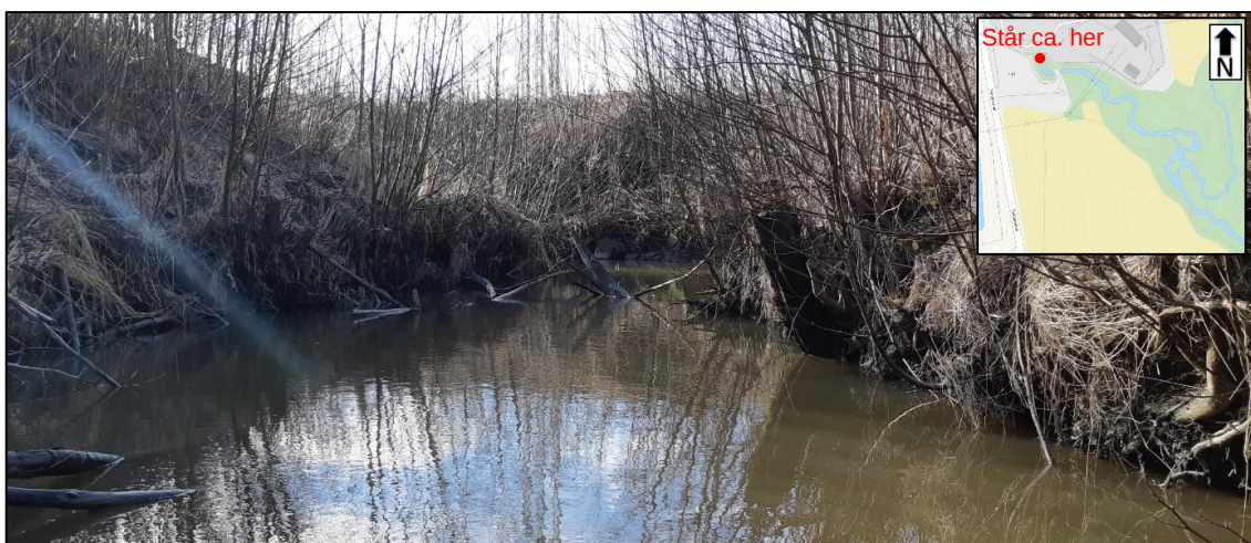
Figur 4.5: Står øst for stålkulverten og tar bilde mot sydøst, som viser synlige røtter langs bekkesidene som indikerer utvasking og pågående erosjon (Fra befarig 09.04.2021)
