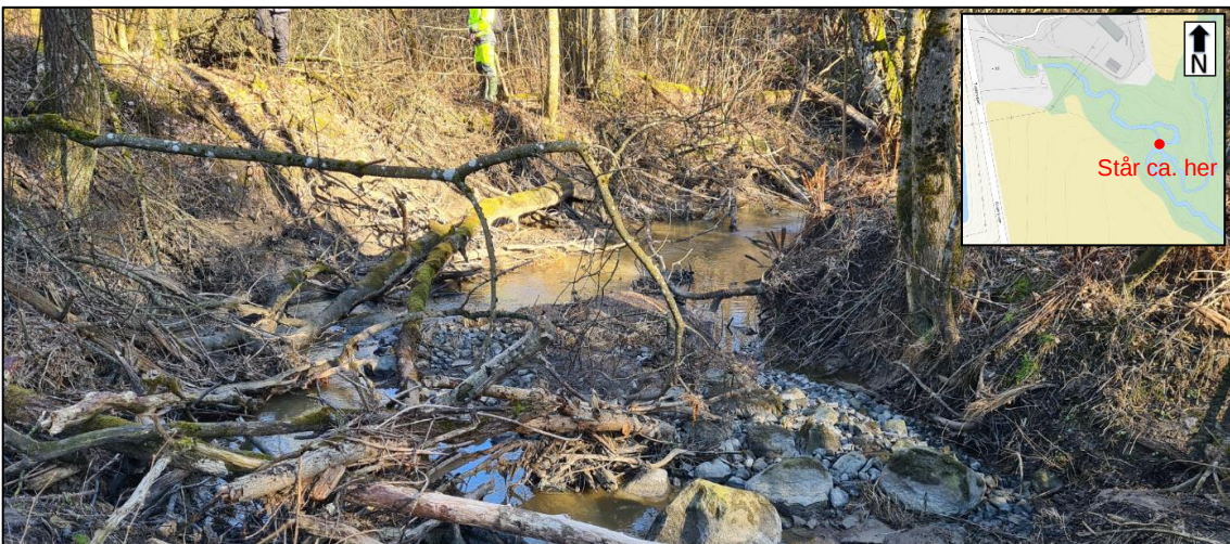
Figur 4.7: Står i ravedalen og tar bilde mot sydøst, som viser synlige røtter og avsetninger av silt og sand langs bekkesidene, som indikerer utvasking og pågående erosjon (Fra befaring 09.04.2021)
