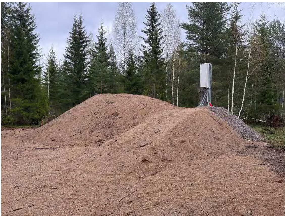
Figur 19: Oversiktsbilde som viser Brønn 7 og elektroskapet som er knyttet til brønnen. Bilde viser at terrenget rundt elektroskap og brønn er høyere enn det opprinnelige nivået.
