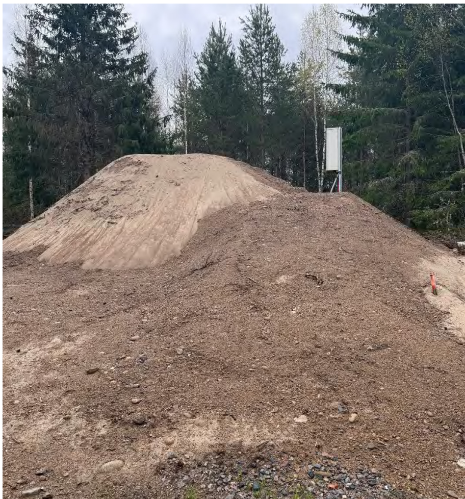
Figur 20: Bilde viser brønn 8 og strømskapet som hører til brønn 8. Bilde viser at terrenget rundt elektroskap og brønn er høyere enn det opprinnelige nivået.
