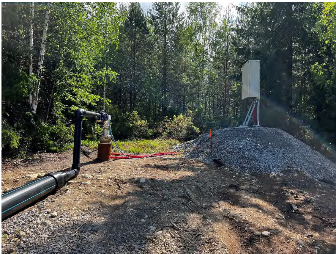
Figur 8: Bilde viser brønn 8 og strømskapet som hører til brønn 8. Det svarte røret fører vannet fra brønnen og ut i Vesle Vingersjøen under pumpeforsøket. Bilde ble tatt under befaring 22.06.2023 av Rambøll.
