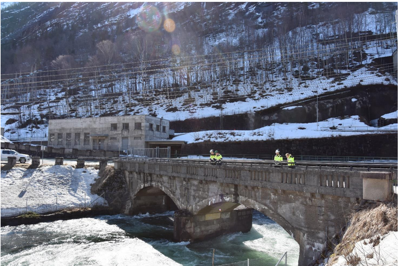
Figur 2-10: Luftledninger mellom utendørsanlegg og Såheimoperaen henger lavt på sørsiden av Såheim bru
