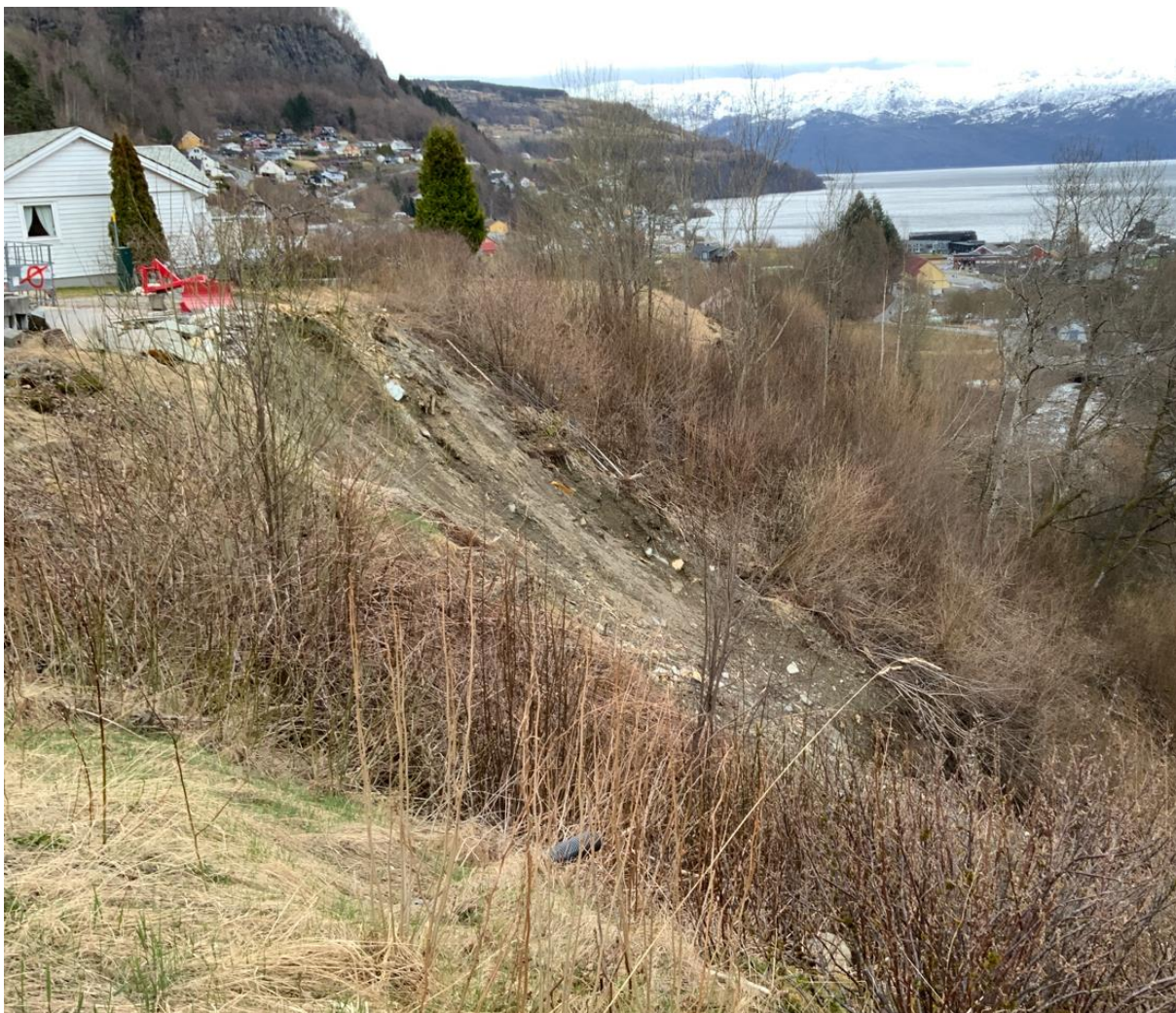
Figur 8: Eksempel på overflateskred etter last/utfylling ved topp skråning. Denne typen skred er ikke vurdert i denne rapporten med mindre de kan berøre sprøbruddmateriale.
