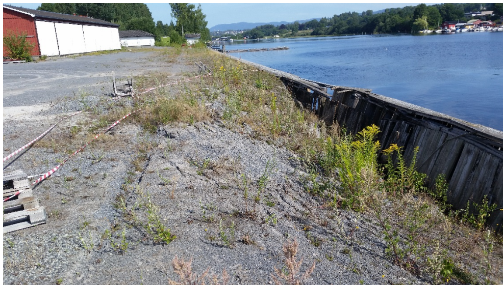
Figur 3: Bildet av svikt i bolverket.
