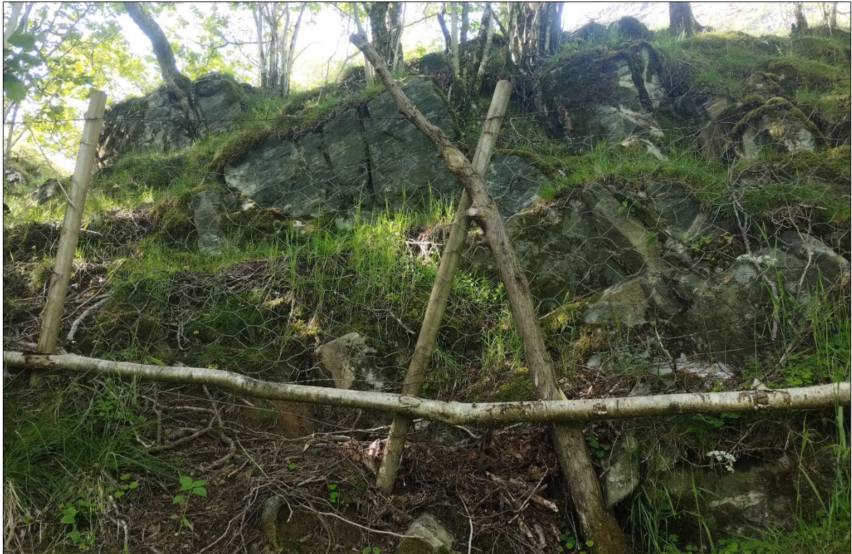
Figur 7: Bildet viser fjell i dagen av kvartsskifer som er kraftig oppsprukket i nordlig del av kartlagt område. Det er enkelte steinsprangblokker på flaten nedenfor denne fjellskrenten. Fjellskrenten er mellom 5-10 m høy. Infopunkt 3
