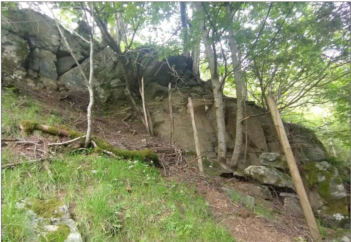
Figur 8: Bildet viser fjellhammer i kartlagt område fra på 5-10 høydemeter. Kvartsskiferen er kraftig oppsprukket, og det ligger enkelte blokker nedenfor skråningsfot. Infopunkt 4
