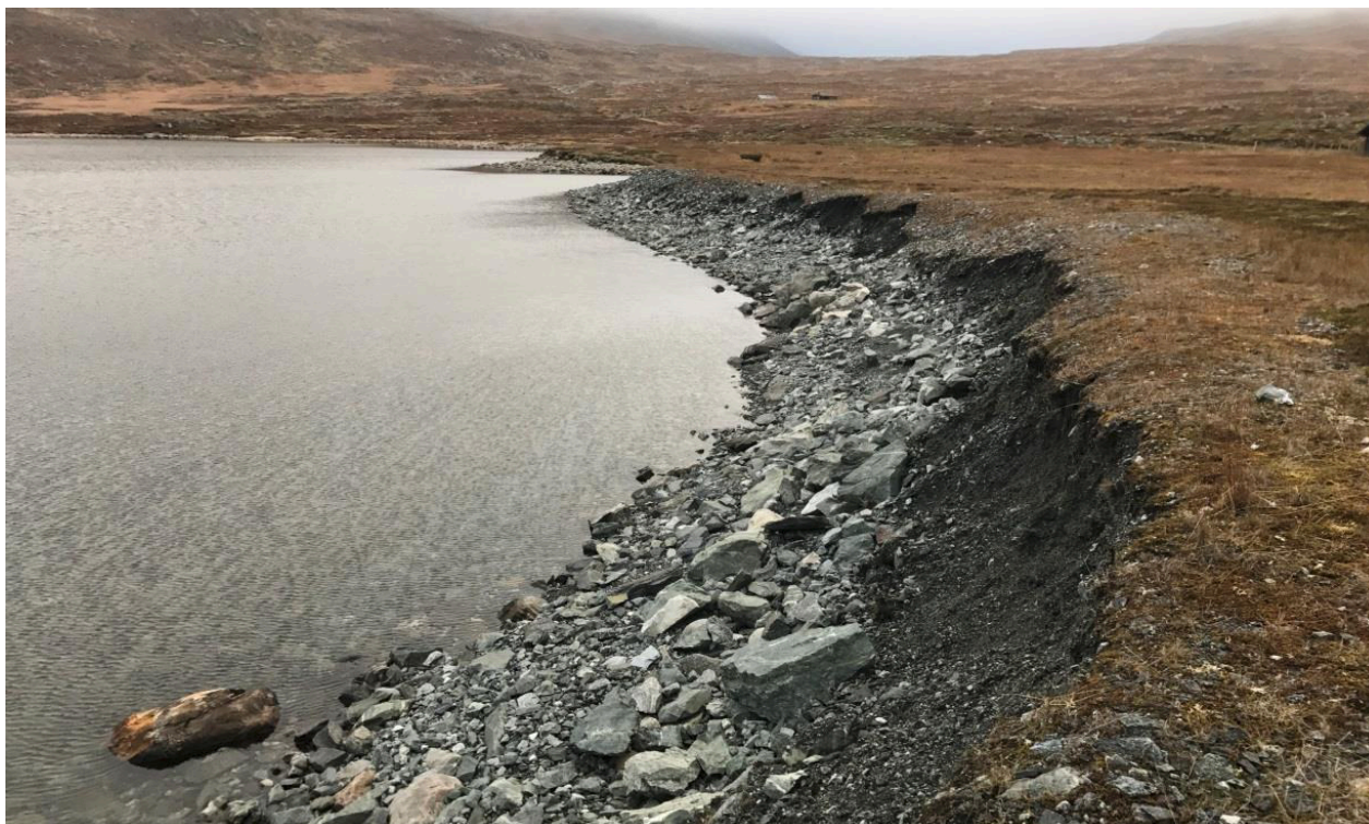
Figur 2: Strekning som antas å være verst påvirket ca. 130 m. Foto: Magne Netland
