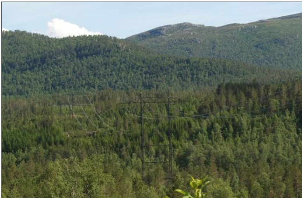
Figur 20 Bilde av kamouflert kraftledning. Linene er mattet, og isolatorene er av kompositt i stedet for av glass som er vanligst å benytte.
