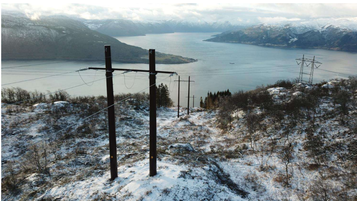
Figur 1-3. Bildet er fra Sygnir sin 132 kV linje til Leikanger kraftverk, Statnett sin 420 kV ledning mellom Sogndal og Høyanger krysser over (Dagshovden ligger helt oppe til venstre i bildet på fjellet på sørsiden av fjorden).
