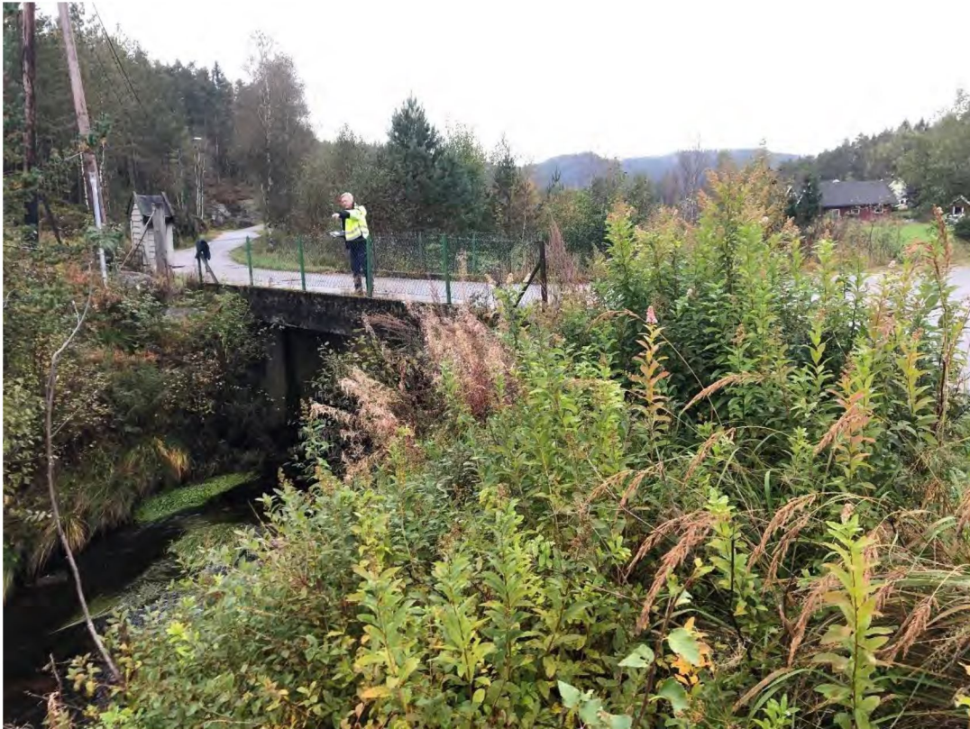
Figur 11. Bru ved Hunemyrvegen sett fra nedstrøm side. Mye kantvegetasjon gjør det vanskelig å få god oversikt.
