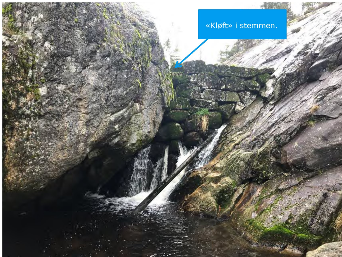
Figur 19. Stemmen sett fra nedstrøms side. Det var synlig store lekkasjer.
