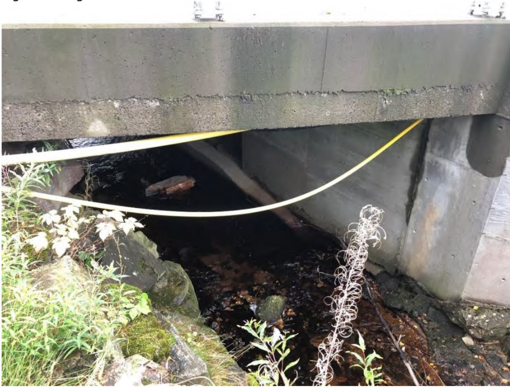
Figur 5. Bru Setesdalsvegen sett fra oppstrøms side.
