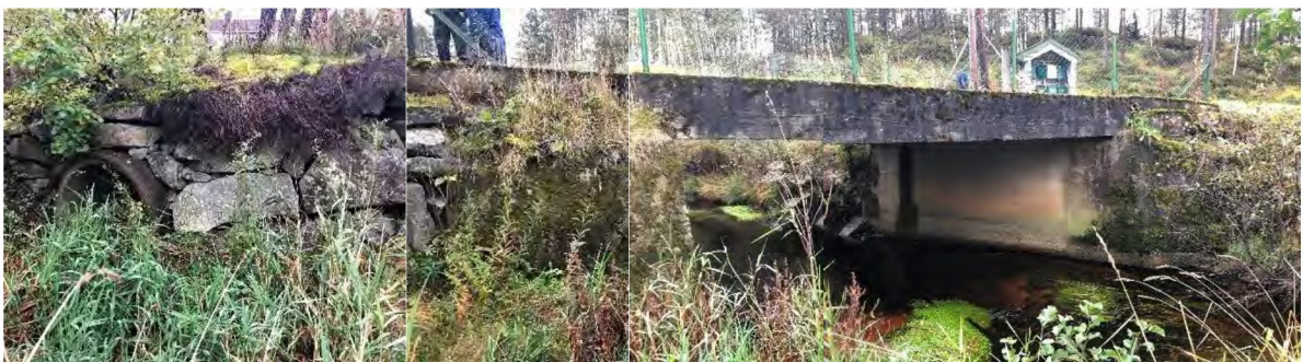
Figur 10. Oppstrøms bru ved Hunemyrvegen (satt sammen av ulike bilder). Det er lagt en Ø1000 betongrør på venstre side i nyere tid i forsøk på å redusere oppstuvning foran bru/øke avledningskapasiteten.
