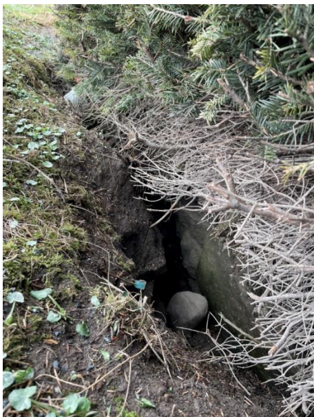
Figur 6 Tomt 193/2, Erosjon mellom kum og hekk, Bilde tatt i 19.02.2021 (Norconsult AS)
