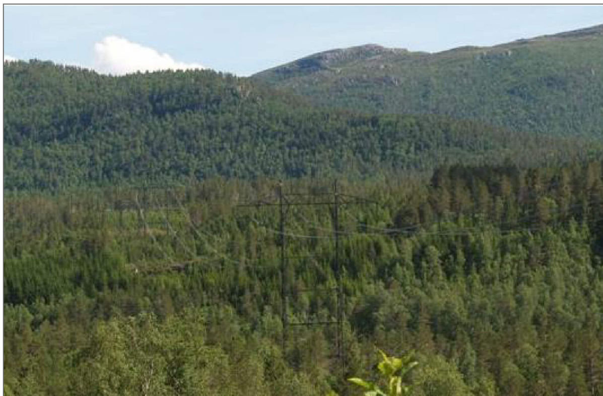
Figur 22 Bilde av kamuflert kraftledning. Linene er mattet, og isolatorene er av kompositt i stedet for av glass som er vanligst å benytte.
