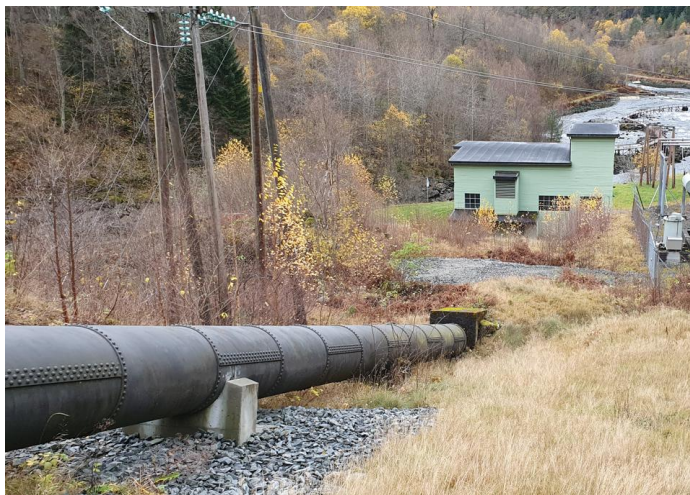
Foto nr. 3. Trykkrør ved innløp til kraftstasjon.
