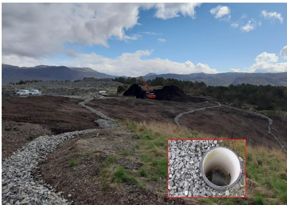
Figur 7: Bildet viser dreneringskanalene som er etablert på det avsluttede deponiet.
