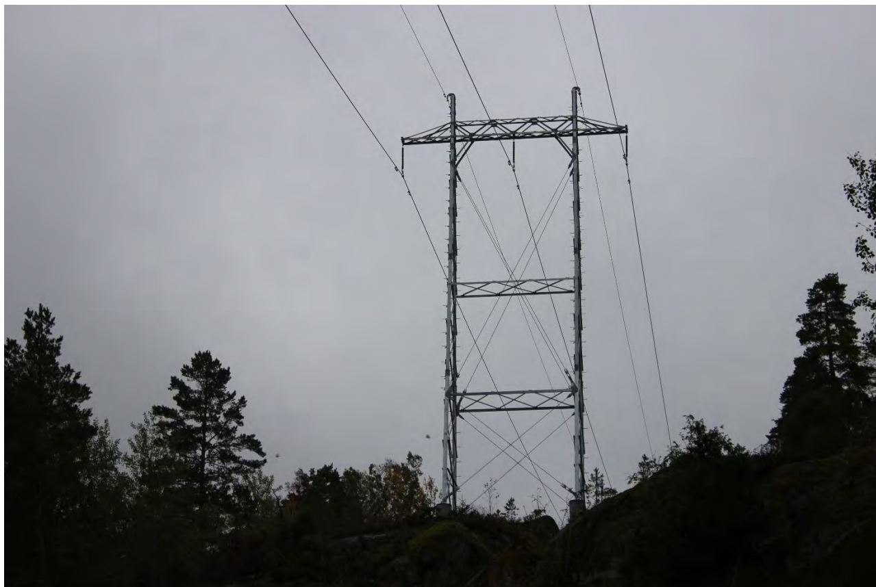
Figur 5-4. Bilde av portalmast i stål.
